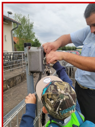
Jetzt kontrollieren wir, ob das Licht an den Gleisen und am Kasten brennt. Durch das Leuchten wissen wir, dass die Schranke unten ist.
